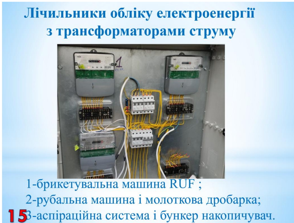
Рисунок 2.6. Фото трьохфазних лічильників з трансформаторами струму для обліку електричної.
