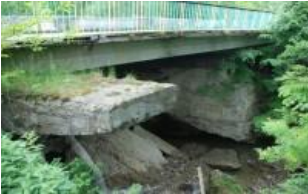
Рис. 4.2 Підмиті опори мосту у м. Бориславі.
