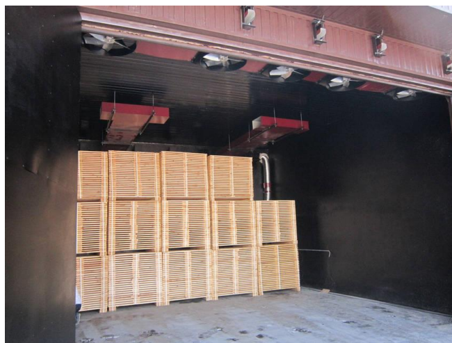
Рис. 5.2. сушильна камера із правильно покладеними штабелями.
