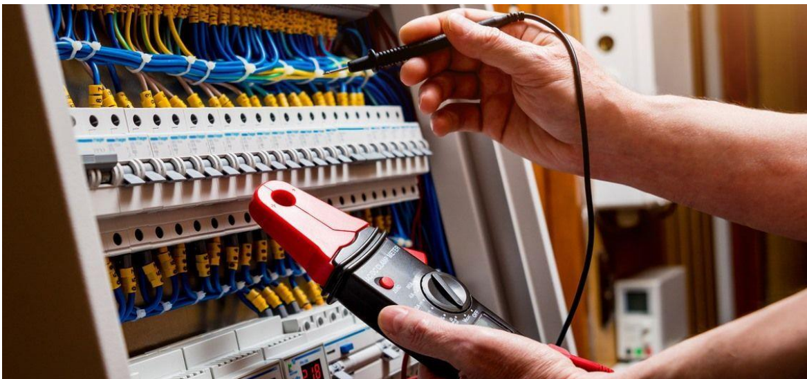
Рис. 2.5 Приклад сучасного якісно виконаного електричного щита у квартирі
