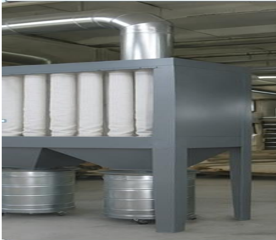
Рисунок 2.2 Рукавний фільтр (фільтраційна установка тонкого очищення повітря)
