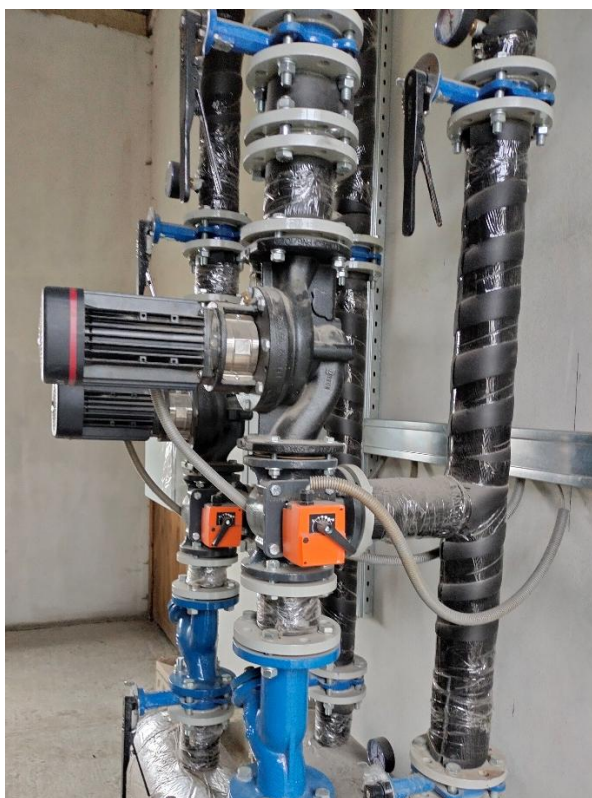
Рисунок 1.10. Фото загального вигляду теплової гребінки.
