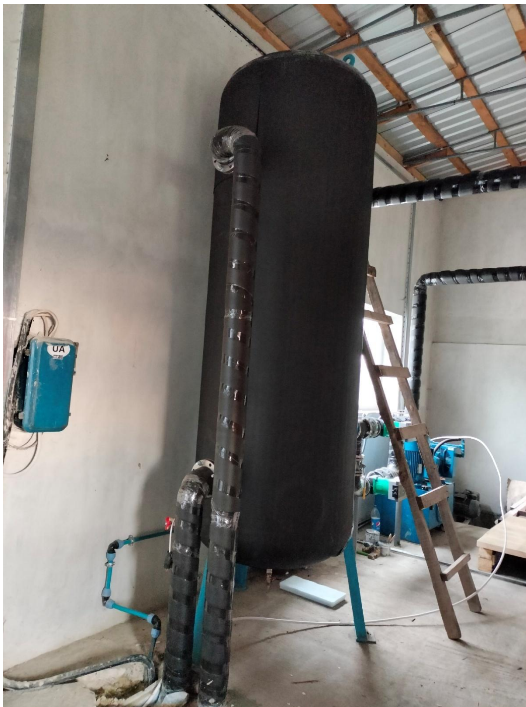
Рисунок 1.11. Фото загального вигляду гідрострілки перед тепловою гребінкою.
