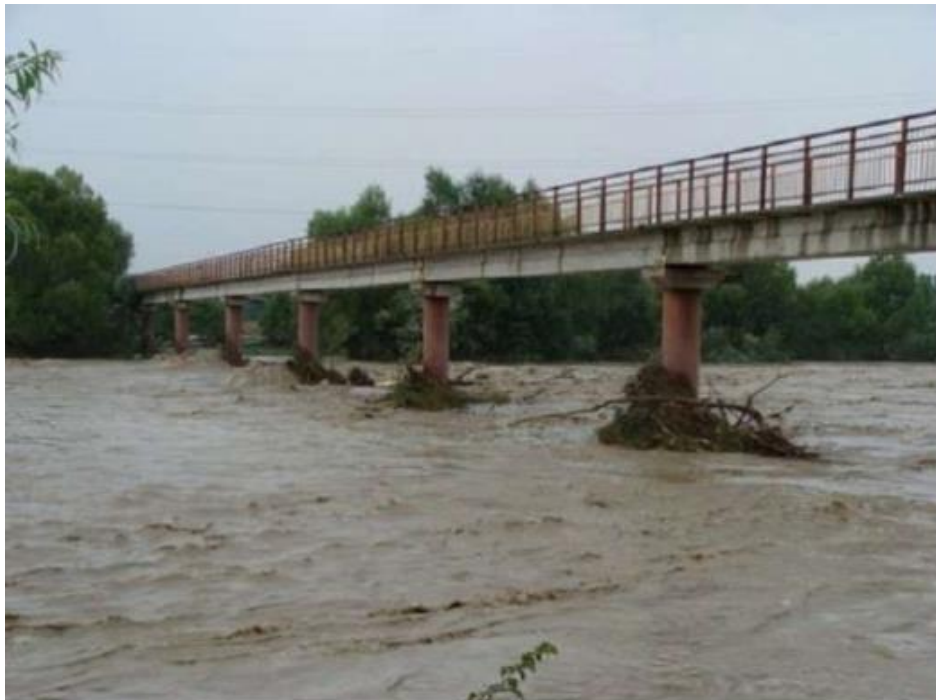
Рис. 4.2. Накопичення сміття під опорами мосту через річку Сірет під час водопілля
