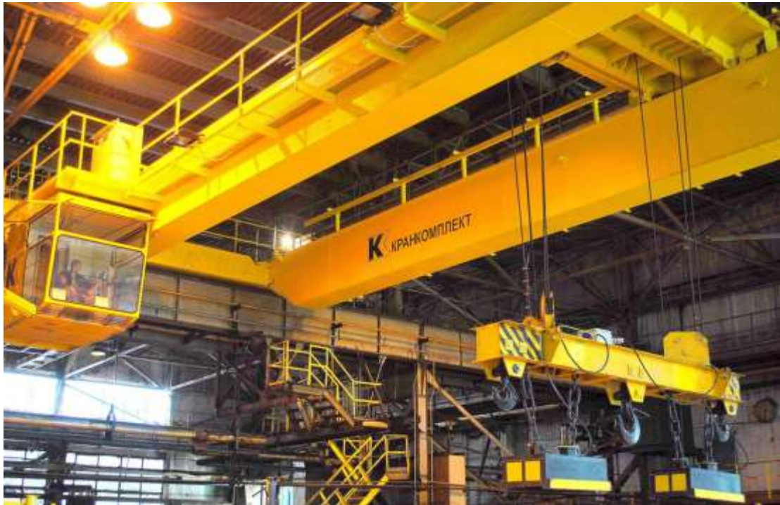
Рисунок 1.2. – Загальний вигляд мостового крана
