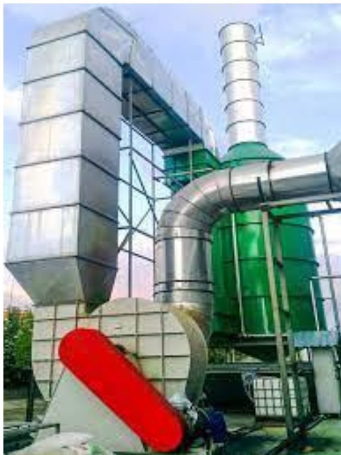
Рис. 3.3 Аспіраційна установка для очистки забрудненого повітря.
