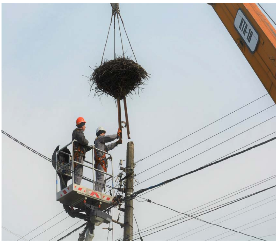
Рис. 4.20.- Гніздо на електропорах від компанії ДТЕК
